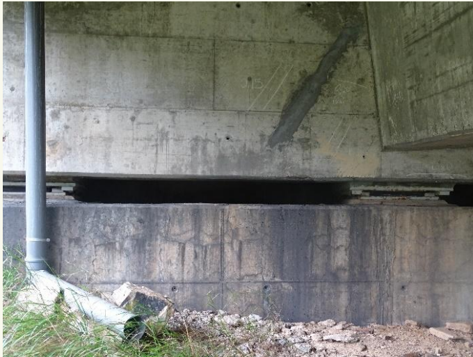
Escorrências na frente dos encontros
