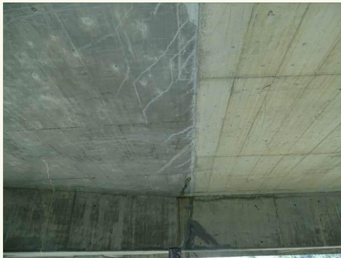
Escorrências através das juntas construtivas
