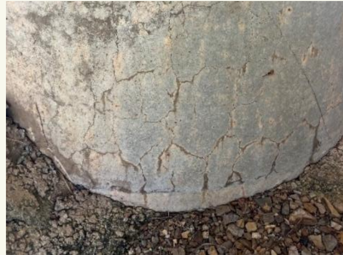
Fendilhação do tipo “craquelê” na base dos pilares
