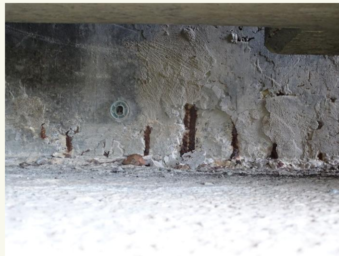
Exposição de armadura nos espelhos dos encontros
