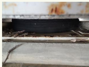
Degradação da protecção anticorrosiva
