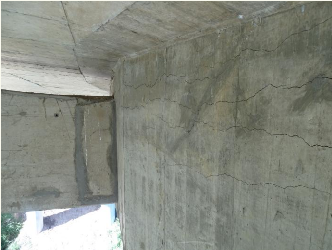
Fendas longitudinais nas vigas
