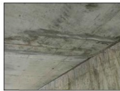
ESCORENCIAS DE ÁGUA NAS LAJES DOS TABULEIROS
