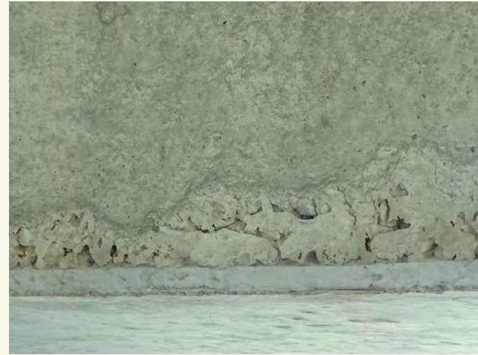
Betão segregado no fundo das vigas
