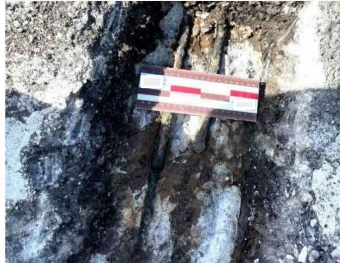
Exposição de armaduras com corrosão na face superior dos tabuleiros
