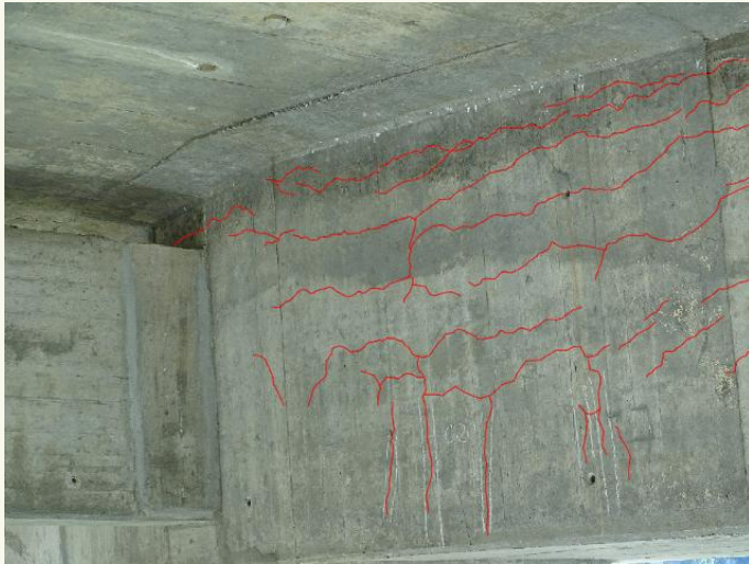
Fendas em malha nas vigas do tabuleiro
