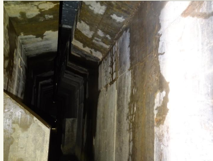
Escorrências nos cachorros das juntas de dilatação
