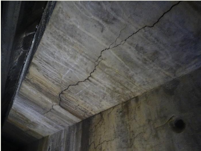
Fendas nos cachorros das juntas de dilatação
