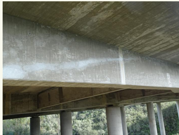
Escorrências nas faces das consolas
