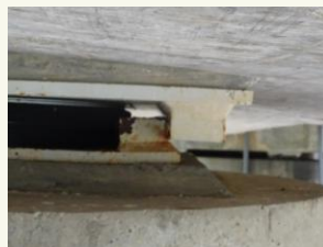
Chapa inferior deformada devido ao contacto entre os batentes.
