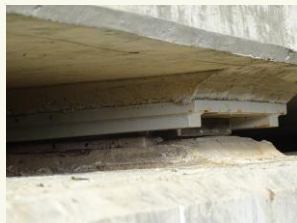
Bloco desposicionado nos encontros
