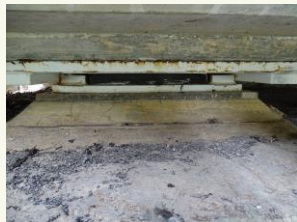
Degração da protecção anticorrosiva
