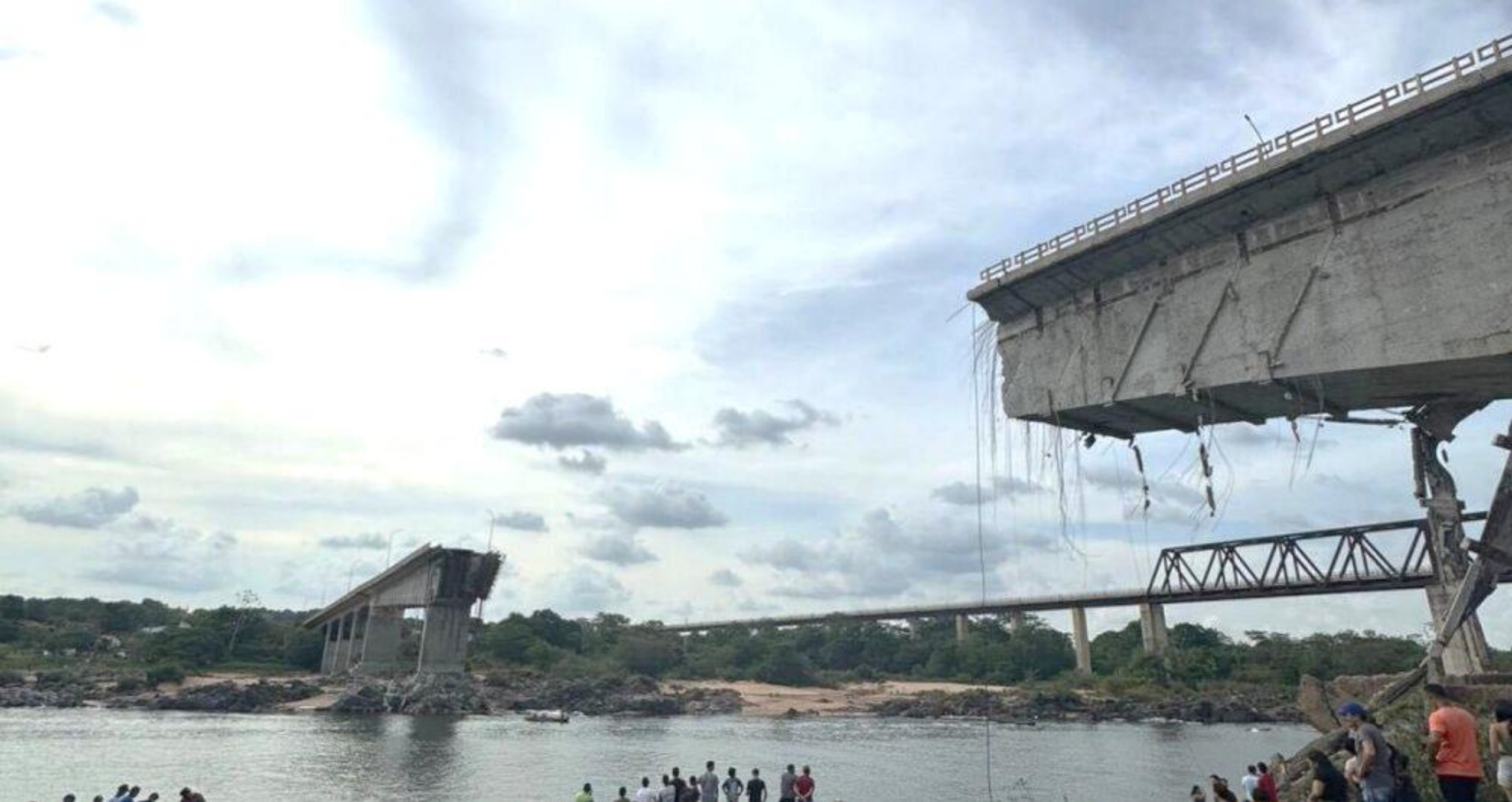
Queda da Ponte de Tocantis (Juscelino Kubitschek de Oliveira, Dezembro 2024)
