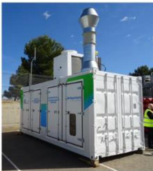
Figura IX - Estação de reabastecimento de hidrogénio
