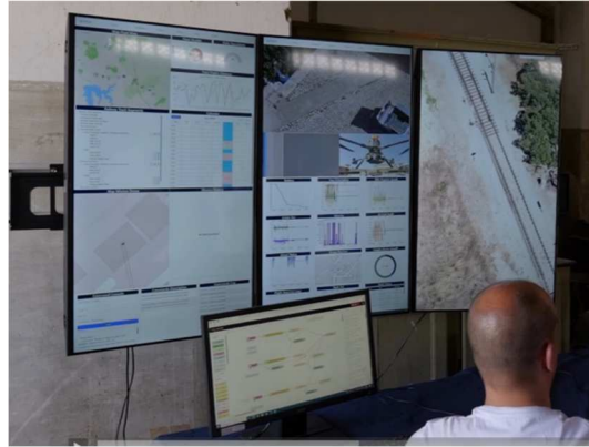
Figura 7 – Centro de Controlo
