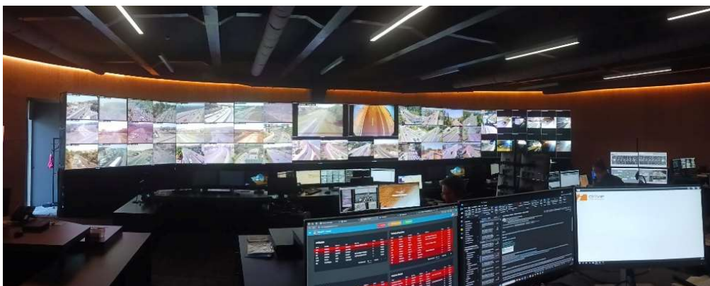
Figura 4 – Centro de Controlo de Tráfego da IP. Fonte IP.
