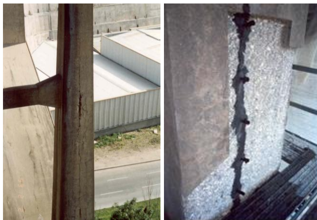
Figura 3 – Fendilhação em pilar e reparação mediante injeção
