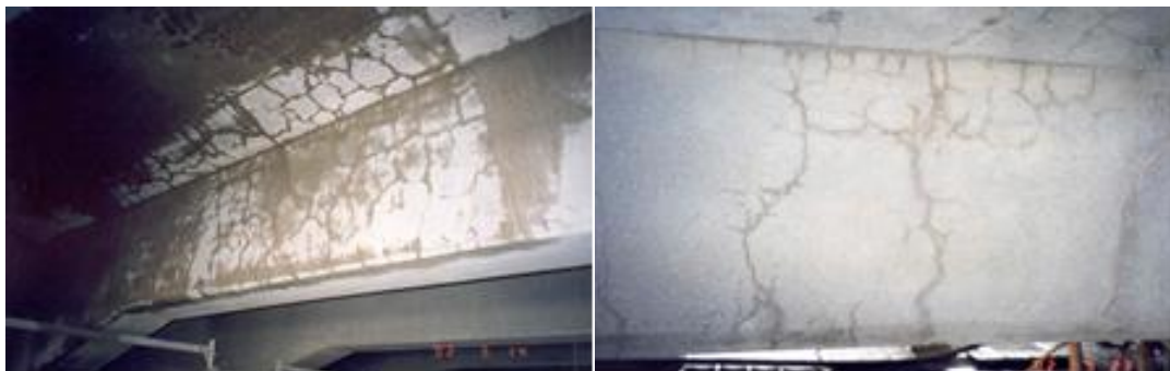
Figura 2 – Fissuração devida a reações álcalis-sílica nas longarinas do tabuleiro do Viaduto Duarte Pacheco
